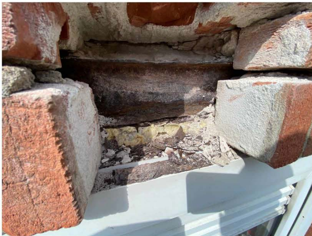
Foto 27. Locatie onderzoek gevelmetselwerk met gecorrodeerde aanwezige stalen latei (GL-4).
