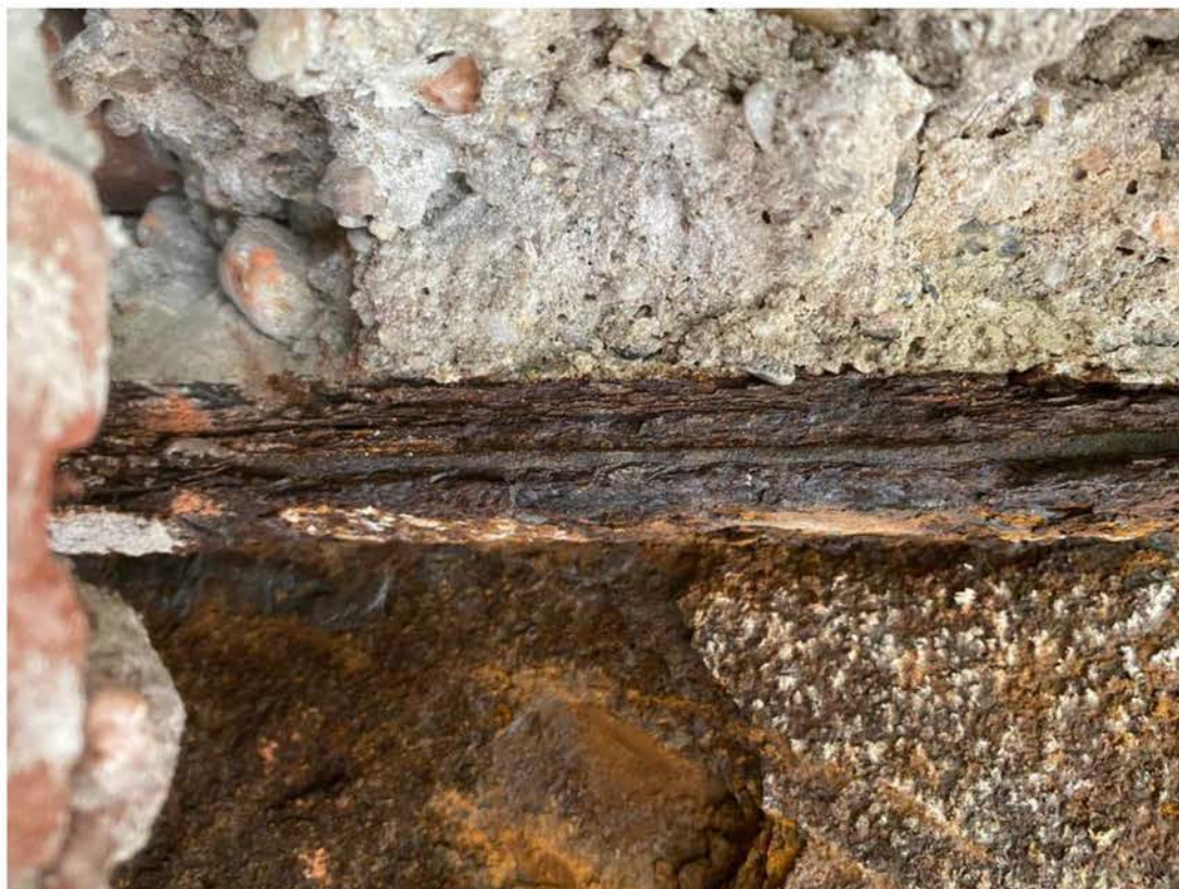
Foto 14. Forse corrosie in flenzen en lijf van de stalen uitbrenger (links) in gevelmetselwerk (SU-2).
