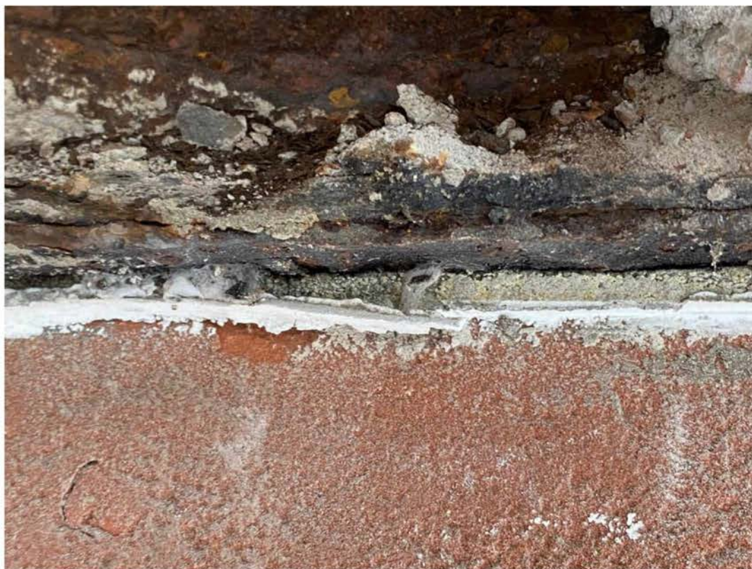
Foto 15. Forse corrosie in flenzen en lijf van de stalen uitbrenger (links) in gevelmetselwerk (SU-2).
