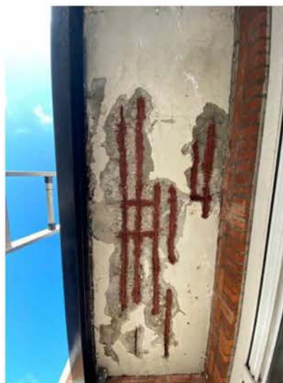
Foto 12. Onderaanzicht balkon 272. Corrosie hoofd- en verdeelwapening.
