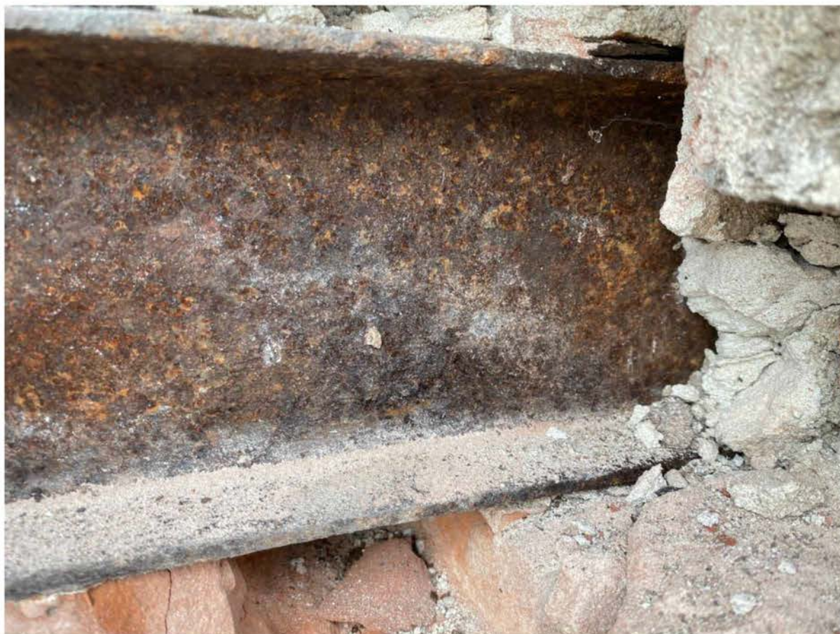
Foto 23. Locatie onderzoek gevelmetselwerk met gecorrodeerde aanwezige stalen latei (GL-2).
