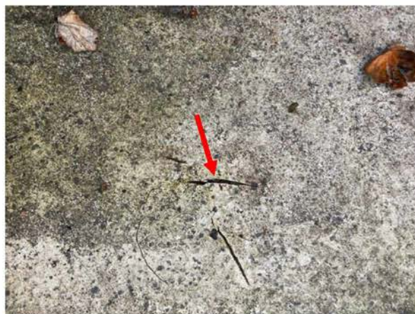
Foto 8. Defecte vloerafwerking balkon 274.
