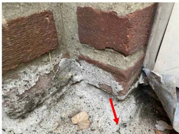
Foto 7. Defecte vloerafwerking balkon 274.
