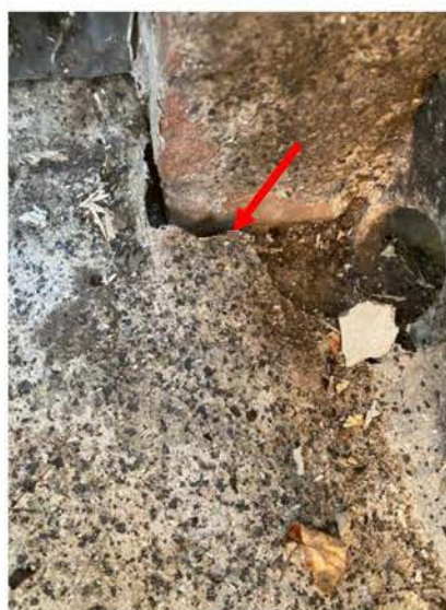
Foto 10. Defecte vloerafwerking balkon 276.
