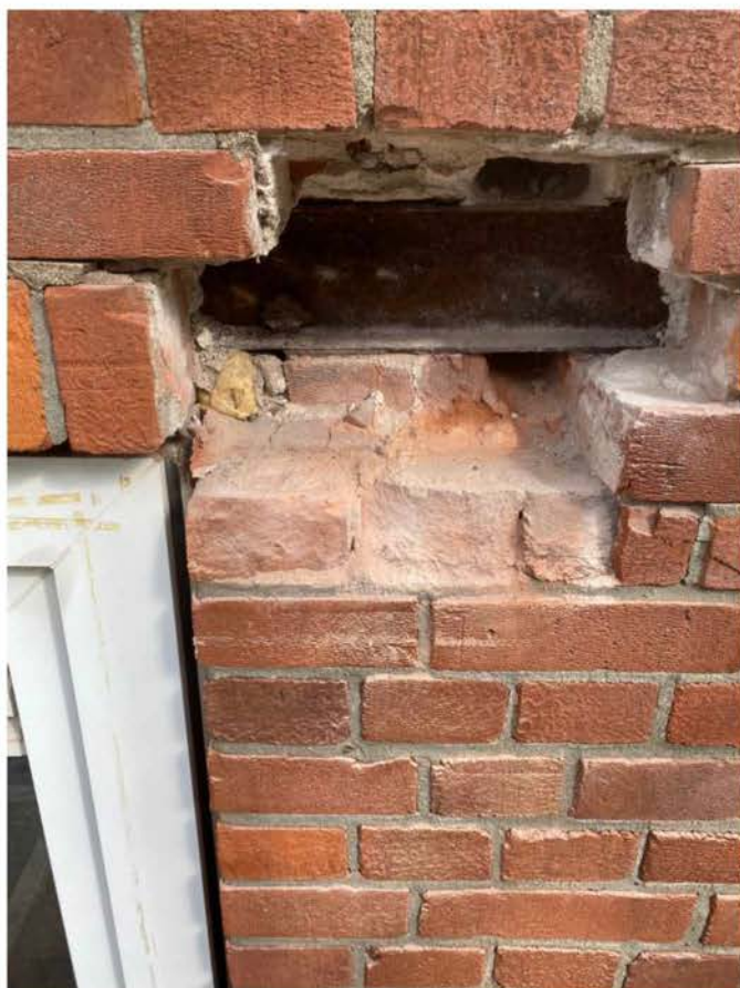
Foto 21. Locatie onderzoek gevelmetselwerk met gecorrodeerde aanwezige stalen latei (GL-2).
