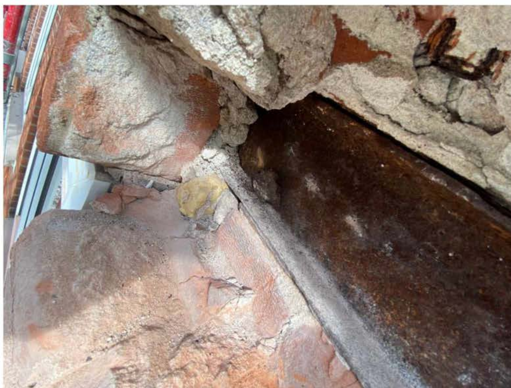
Foto 22. Locatie onderzoek gevelmetselwerk met gecorrodeerde aanwezige stalen latei (GL-2).
