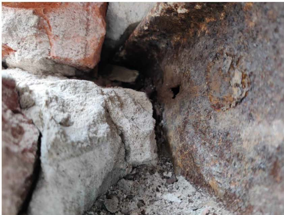
Foto 25. Locatie onderzoek gevelmetselwerk met gecorrodeerde aanwezige stalen latei (GL-3).
