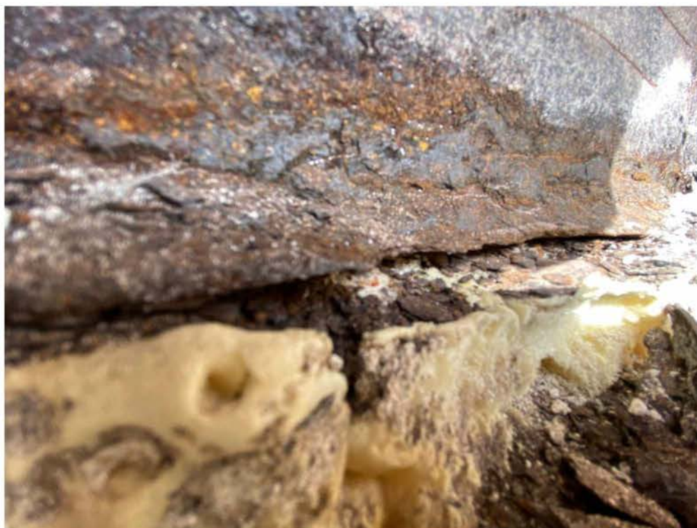
Foto 29. Locatie onderzoek gevelmetselwerk met gecorrodeerde aanwezige stalen latei (GL-4).
