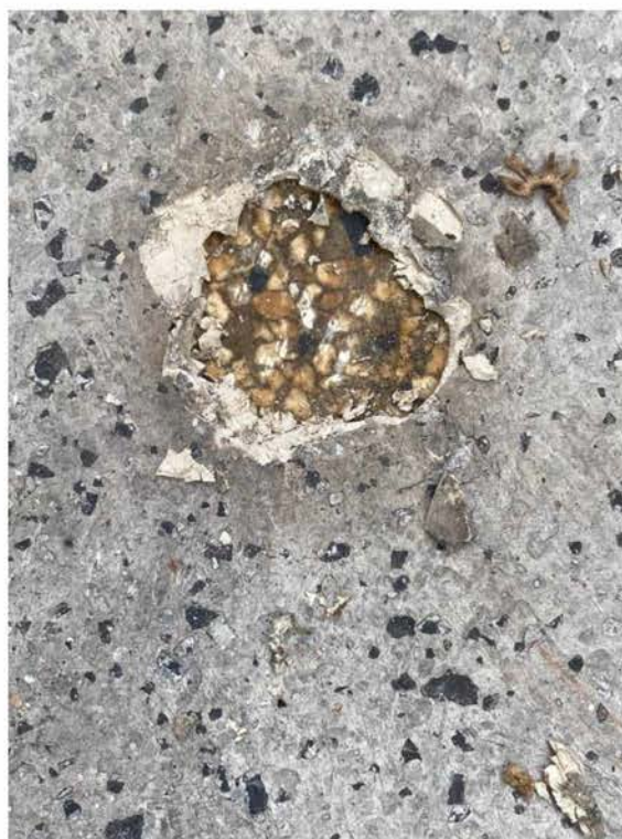
Foto 25. Defecte vloerafwerking balkon 258.
