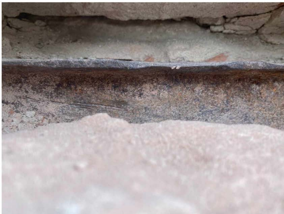
Foto 26. Locatie onderzoek gevelmetselwerk met gecorrodeerde aanwezige stalen latei (GL-3).
