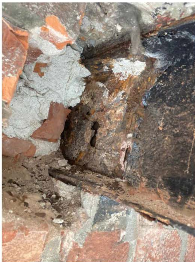
Foto 6. Forse corrosie in flenzen en lijf van de stalen uitbrenger (links) in gevelmetselwerk (SU-1).
