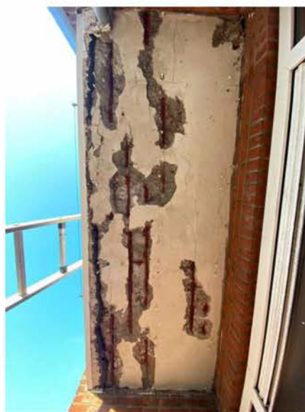
Foto 6. Onderaanzicht balkon 274. Corrosie hoofdwapening.
