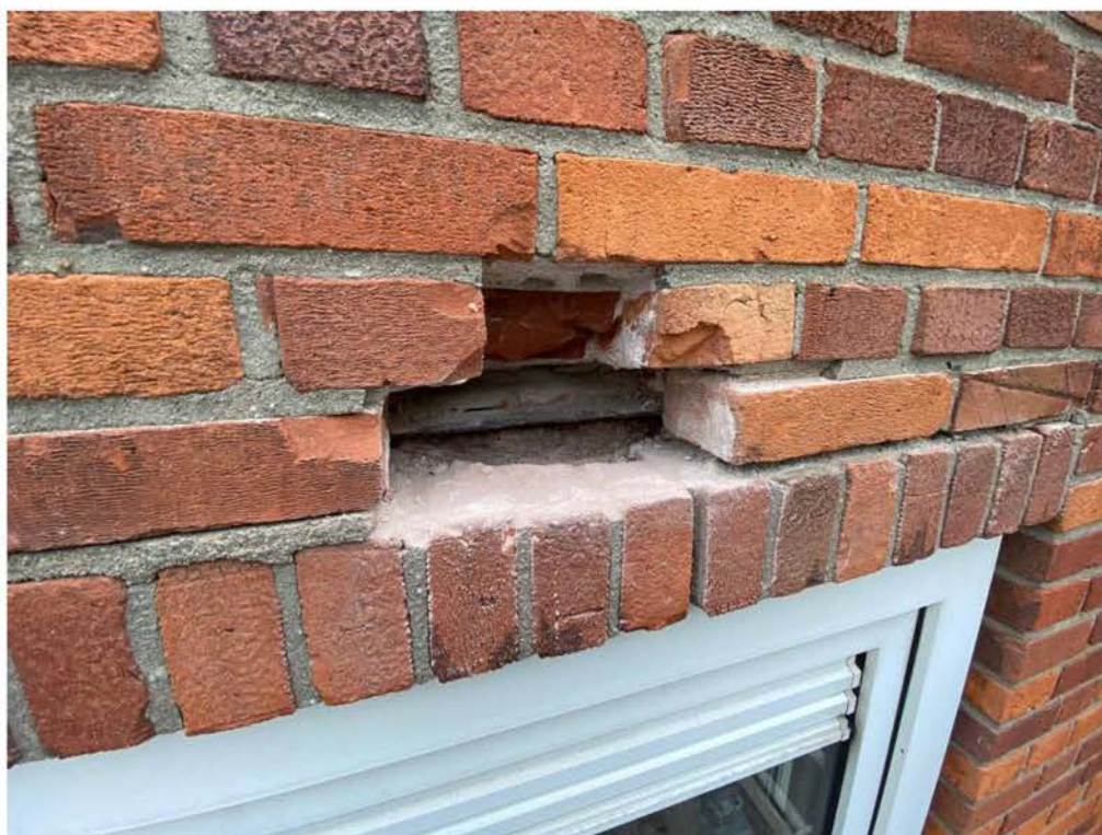
Foto 24. Locatie onderzoek gevelmetselwerk met gecorrodeerde aanwezige stalen latei (GL-3).
