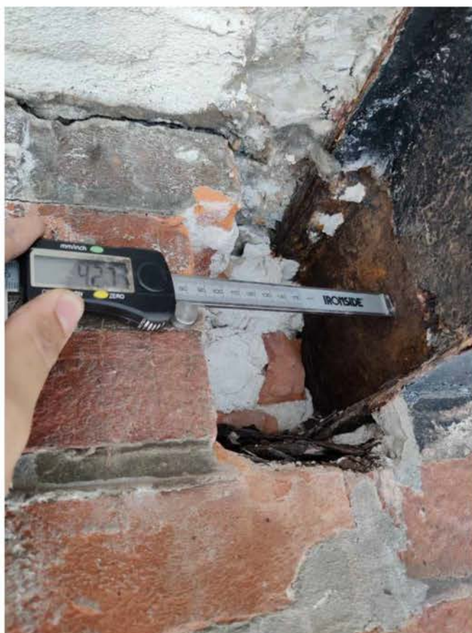
Foto 8. Meting dikte lijf na verwijderen gecorrodeerde delen (SU-1).
