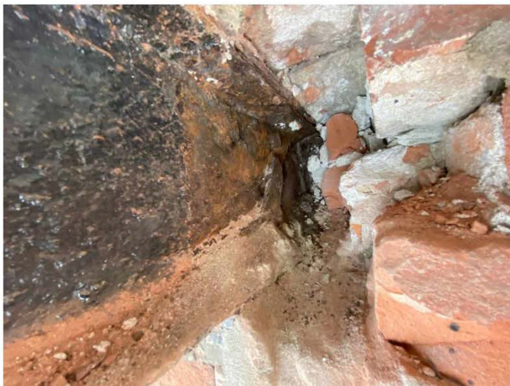
Foto 7. Forse corrosie in flenzen en lijf van de stalen uitbrenger (rechts) in gevelmetselwerk (SU-1).
