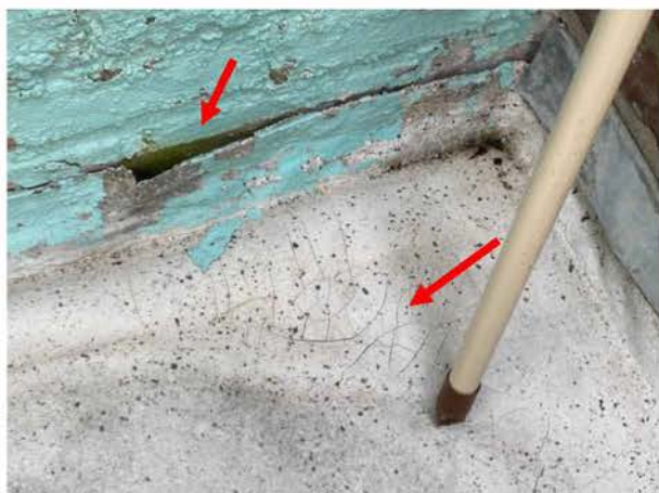
Foto 23. Defecte vloerafwerking en afdichting gemetselde wand balkon 260.
