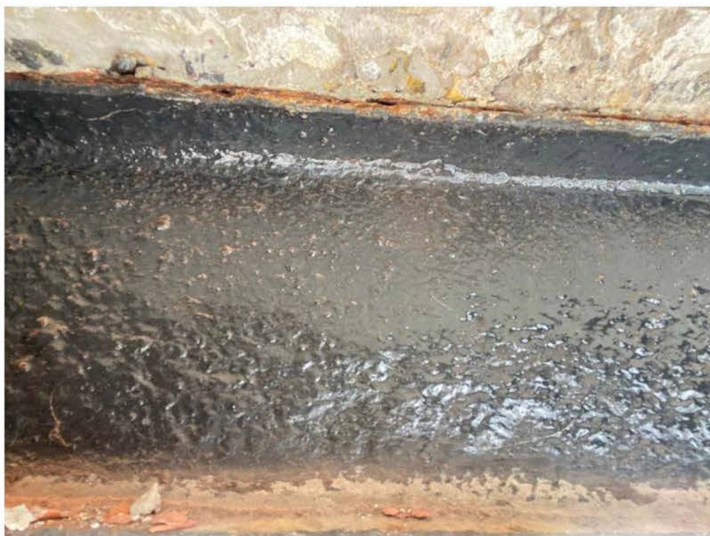
Foto 5. Corrosie in flenzen en lijf van de stalen uitbrenger (SU-1).
