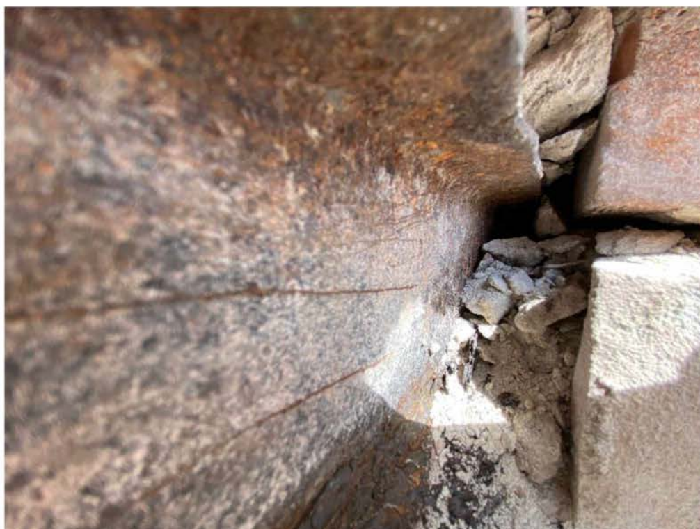
Foto 30. Locatie onderzoek gevelmetselwerk met gecorrodeerde aanwezige stalen latei (GL-4).
