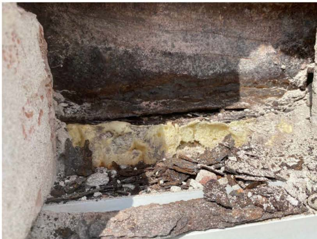
Foto 28. Locatie onderzoek gevelmetselwerk met gecorrodeerde aanwezige stalen latei (GL-4).
