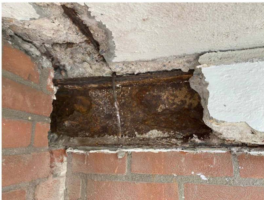
Foto 12. Forse corrosie in fleen en lijf van de stalen uitbrenger (links) in gevelmetselwerk (SU-2).
