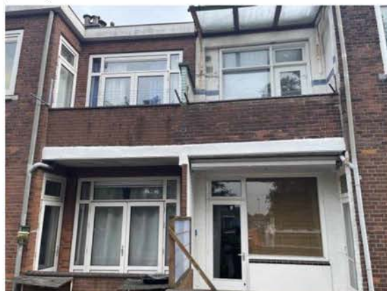
Foto 4. Aanzicht balkon nr. 260 (linksboven) en 258 (linksonder)
