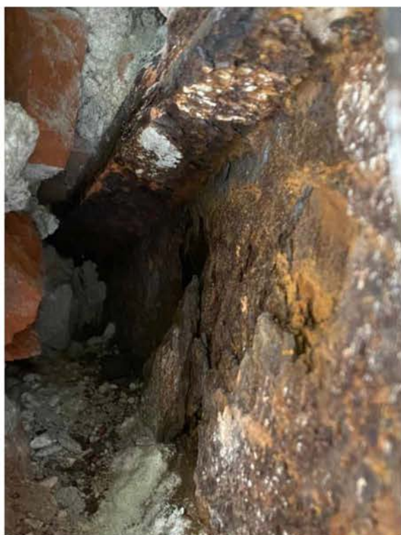
Foto 13. Forse corrosie in fleen en lijf van de stalen uitbrenger (links) in gevelmetselwerk (SU-2).
