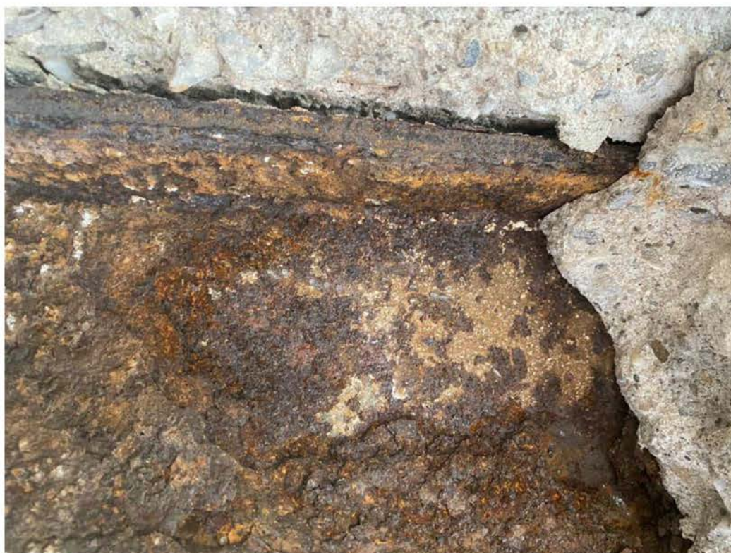
Foto 16. Forse corrosie in flenzen en lijf van de stalen uitbrenger (links) in gevelmetselwerk (SU-2).
