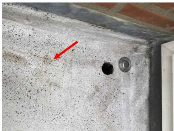
Foto 22. Defecte vloerafwerking balkon 260.
