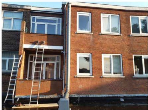
Foto 1. Aanzicht balkon nr. 274 (boven) en 276 (onder).
