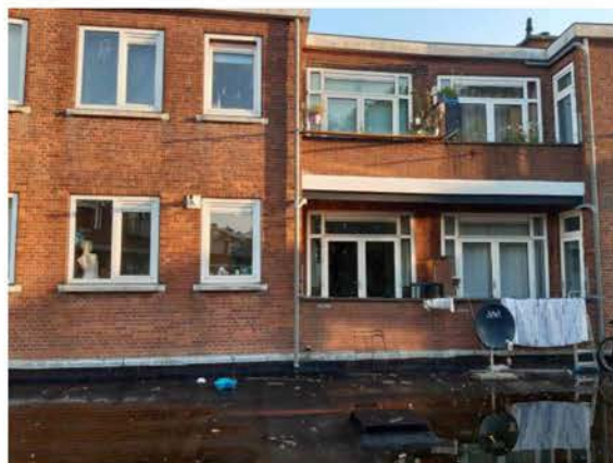
Foto 2. Aanzicht balkon nr. 272/262 (boven) en 270/264 (onder).
