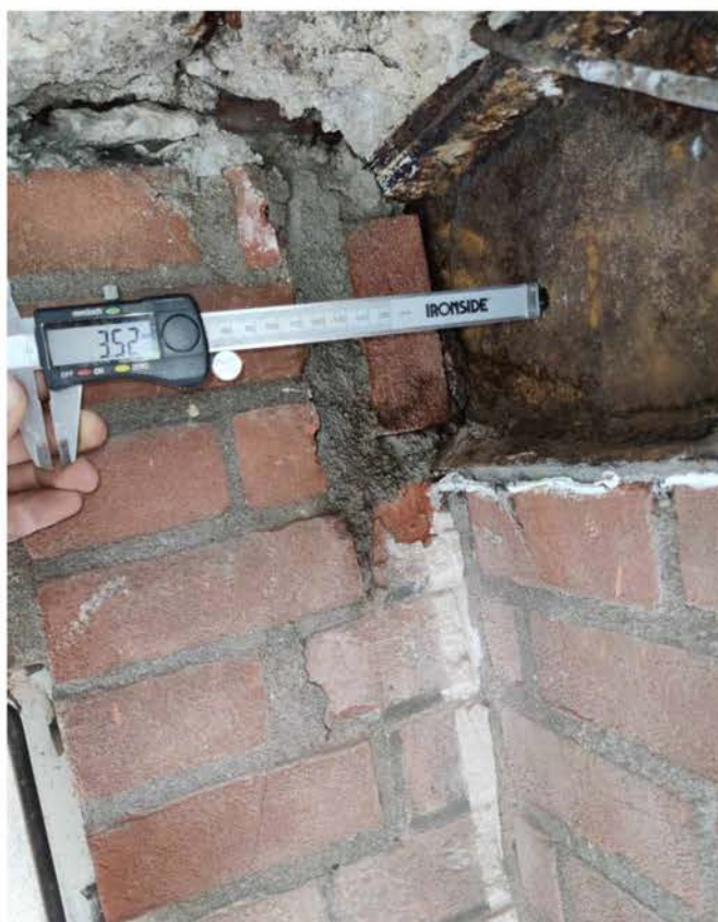
Foto 17. Meting dikte lijf na verwijderen gecorrodeerde delen (SU-1).
