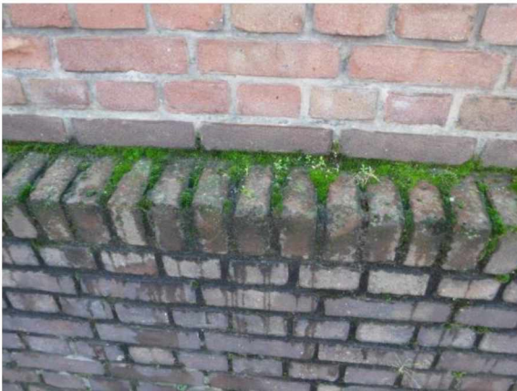
voegwerk niet intact
