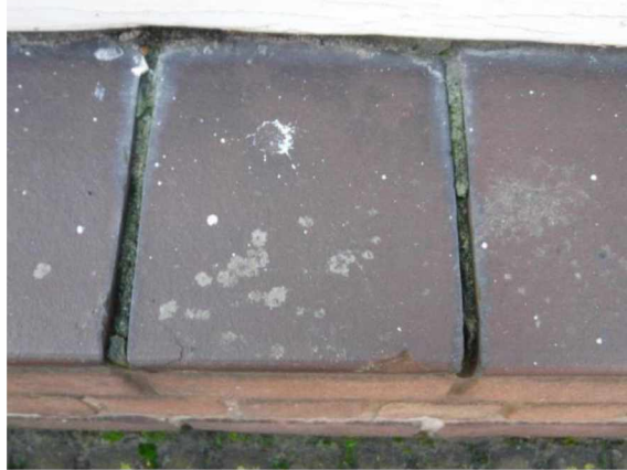
voegwerk niet intact
