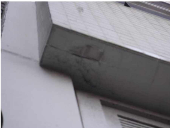
schade door vochtophoping
