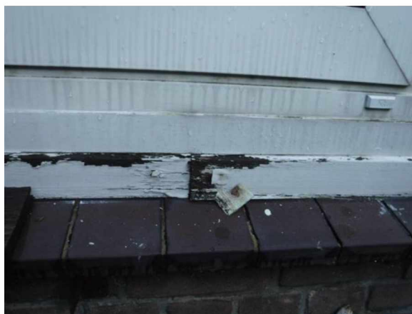
aangetast hout door ondeugdelijke constructie
