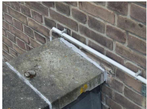
16: kitvoegen verkeren in matige staat
