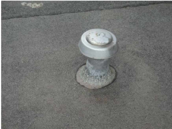
37: aanwezige ontluchting (enkelwandig)
