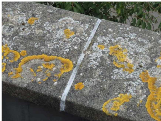
15: kitvoegen verkeren in matige staat
