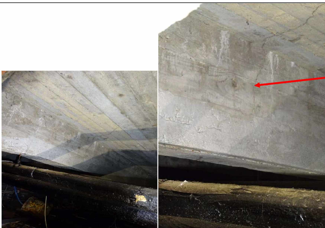
Foto 3: een scheur in de betonnen balk die doorloopt naar de vloer.
