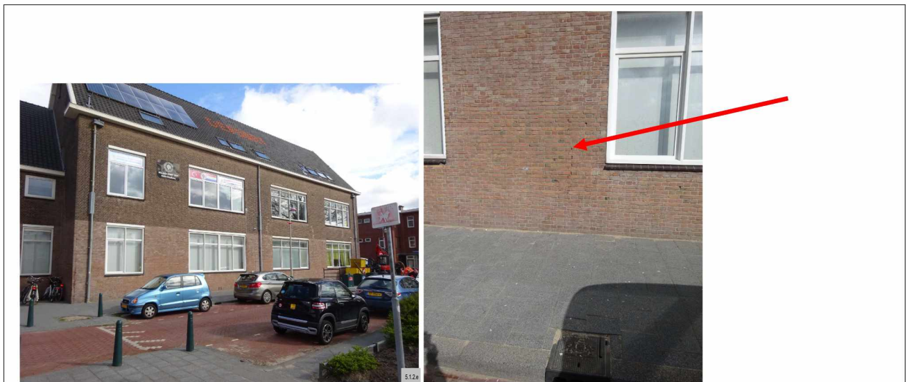
Foto 1: overzicht van een deel van de voorgevel waar diverse scheuren zijn aangetroffen.
