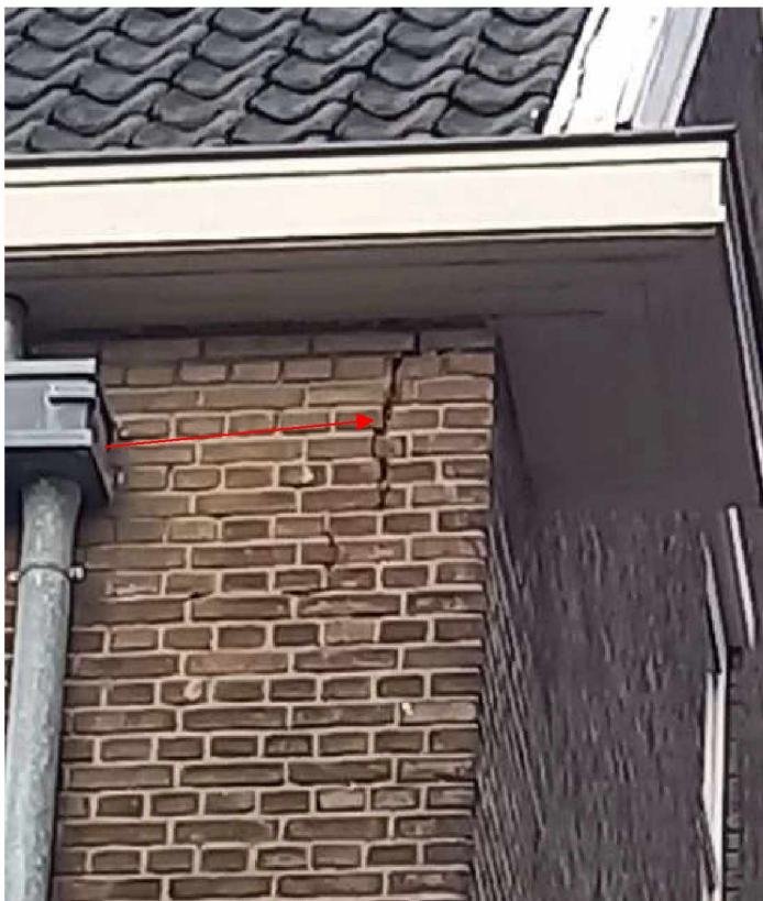
Foto 4 Scheurvorming zijde Ledeganckplein linker zijgevel hoek
