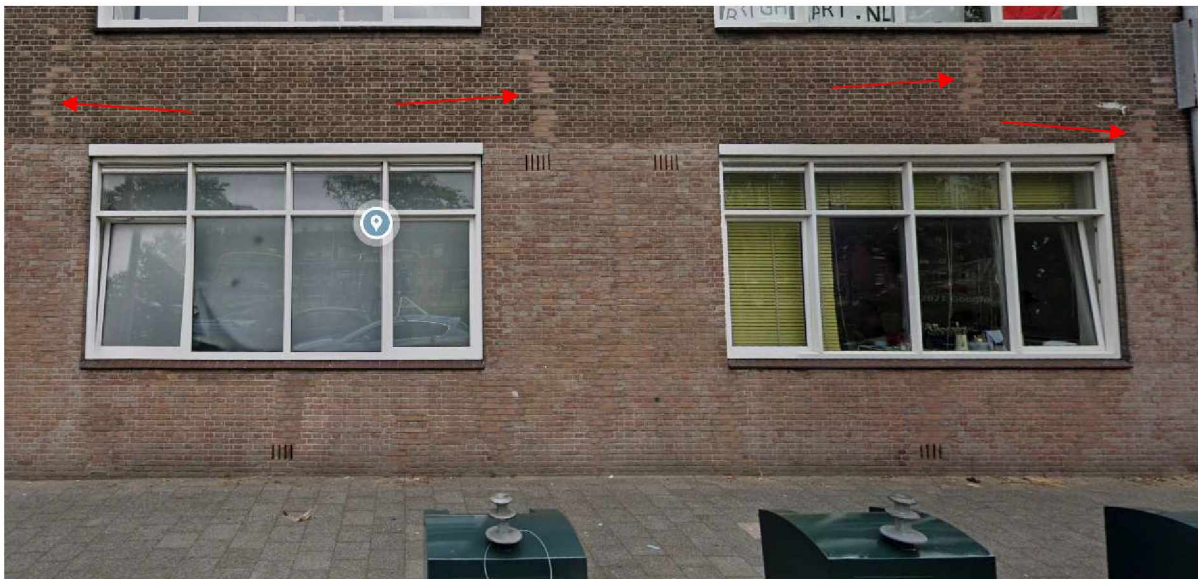
Foto 3 Scheurvorming hersteld zijde Ledeganckplein linker zijdegevel
