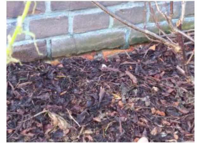
Voegen staan open in de tuin.
