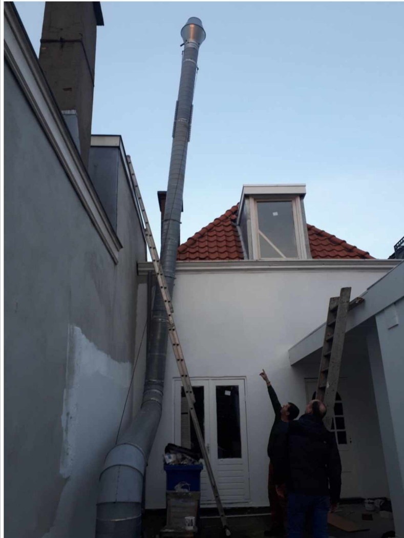
Niet afdoende geschoorde rookgasafvoerpijp
